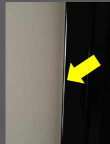
ATゴム劣化による光漏れ
