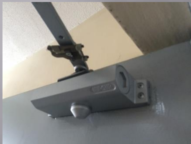
ドアクローザーのオイル漏れ
